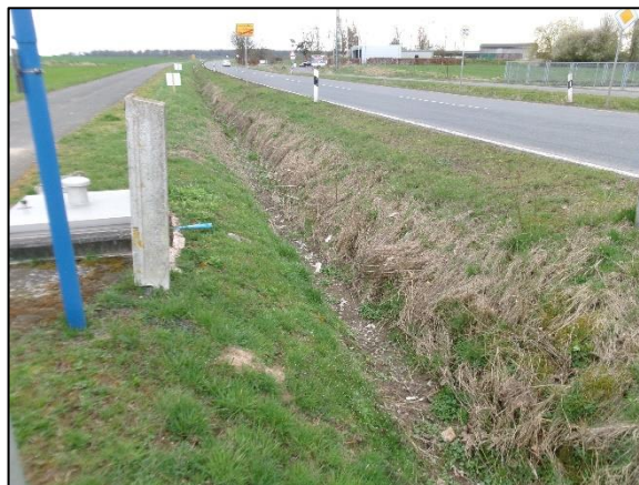
Abb. 21: Entwässerungsgraben und Straßenbegleitgrün im Bereich der Alsfelder Straße.
