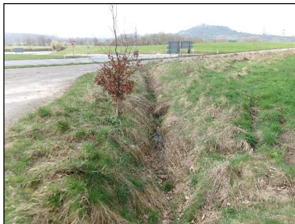
Abb. 13: Verkrauteter Graben am östlichen Rand des Plangebietes.
