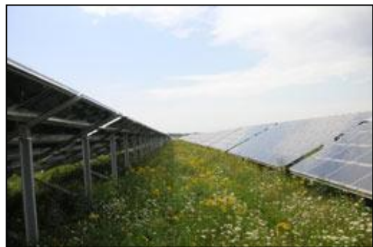
Abb.15: Beispiel für aufgeständertes Modulfeld
