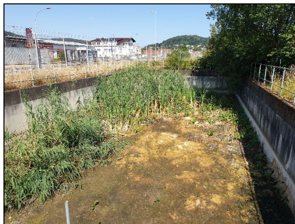
Abb. 6: Blick von Westen in die Regenrückhaltebecken.
