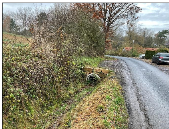
Abb. 6: Ein Teilabschnitt des nördlich verlaufenden Grabens ist verrohrt und mit einer Schotterfläche versehen.
