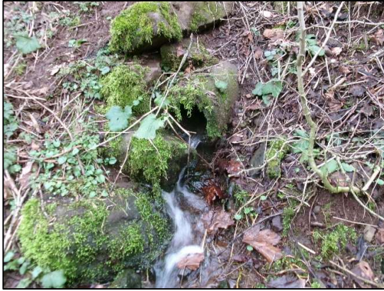
Abb. 6: Wasseraustritt aus einem verrohrten Graben innerhalb der Wegeparzelle 110.
