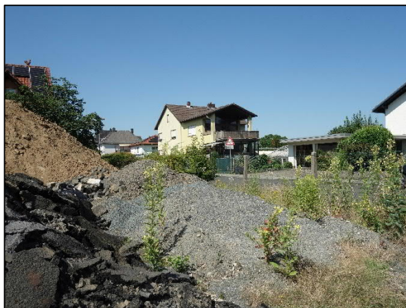
Foto 20: Bewachsene Ablagerungen aus Stein und Kies im Osten des Plangebietes. Blick von Süden nach Norden.
