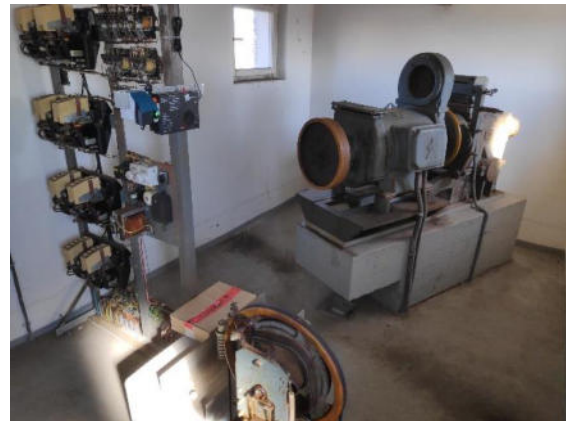
Aufzugsmaschinenraum Halle J, Verdacht auf asbesthaltige Bremsbeläge
