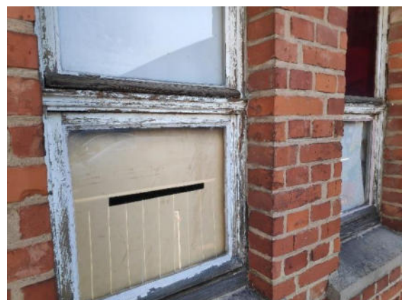
Altes Holzfenster Asbesthaltiger Fenterkitt, Halle I Vorderseite
