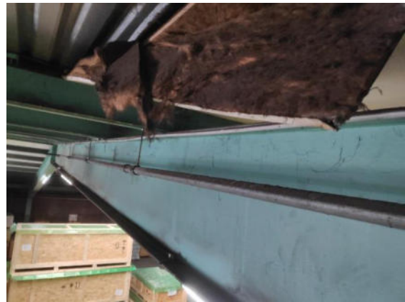
KMF-haltige Dämmplatten an Decke, Hallen L und O
