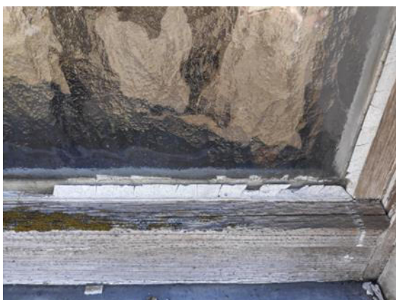
Asbesthaltiger Fensterkitt Aufzugsmaschinenraum, Halle J (Detail)
