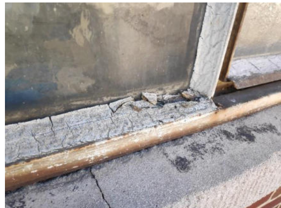
Asbesthaltiger Fenterkitt, Halle Q (Detail)
