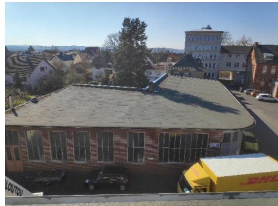
PAK-belastete Bitumenabdichtung, Halle Q
