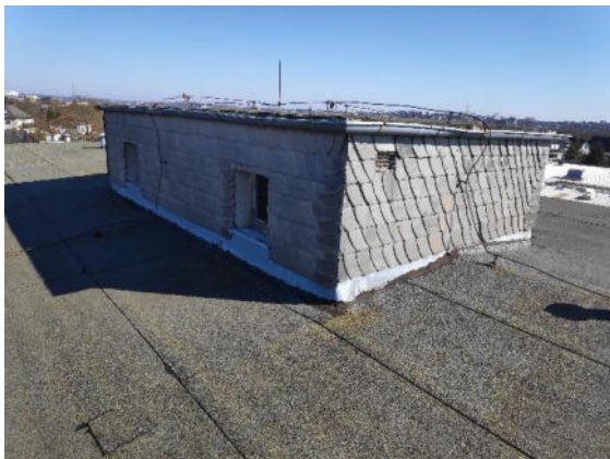
Asbesthaltiger Fensterkitt Aufzugsmaschinenraum, Halle J
