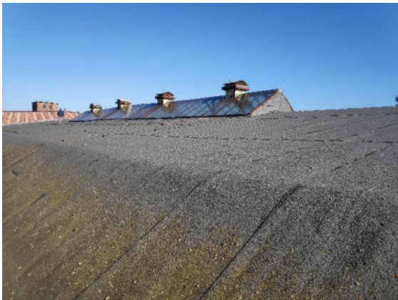
PAK-belastete Bitumenabdichtung, Halle I
