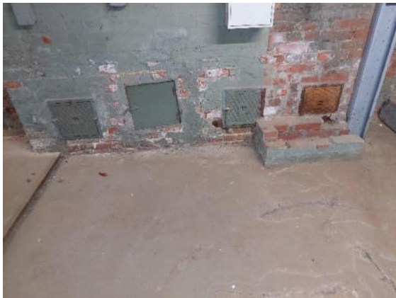
Kamindeckel mit pot. asbesthaltigen Dichtungen, Heizungsraum Halle I
