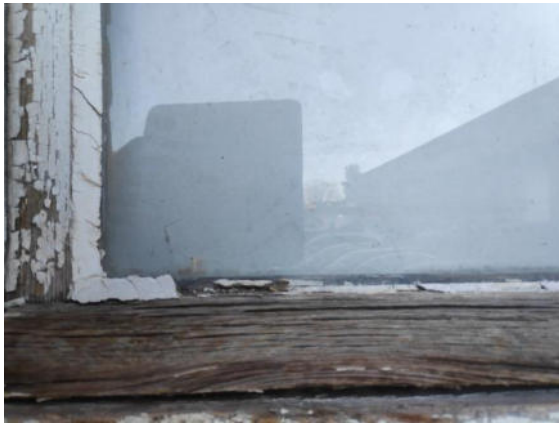
Asbesthaltiger Fenterkitt, Halle I (Detail)
