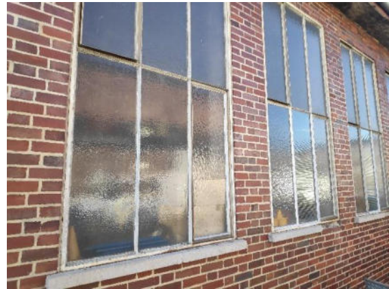
Asbesthaltiger Fenterkitt, Halle Q
