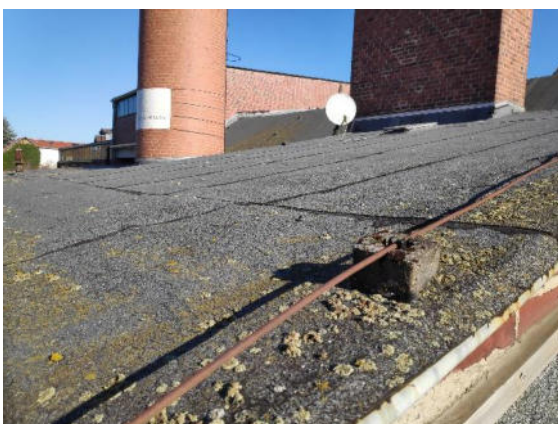
PAK-belastete Bitumenabdichtung, Halle I
