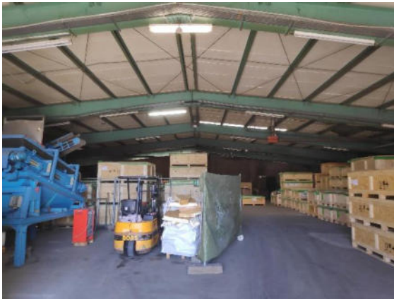
Blick in Halle L: asbesthaltiger Asphaltestrich und KMF-haltige Dämmplatten
