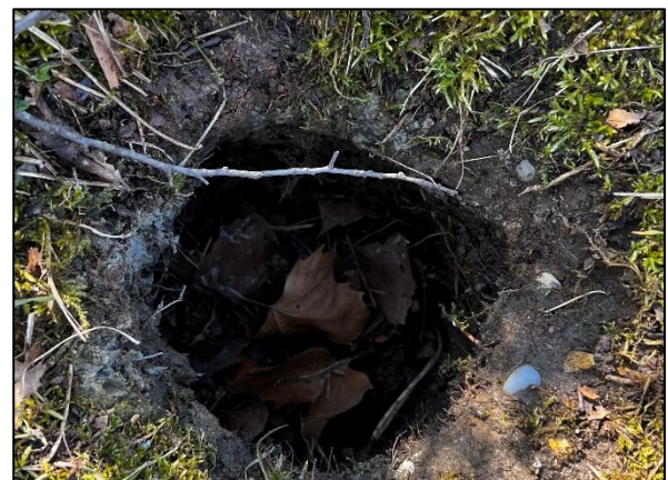
Abb. 25: Erdloch auf dem Boden des Grünstreifens des Parkplatzbereiches. (eigene Aufnahme, 03/2025)
