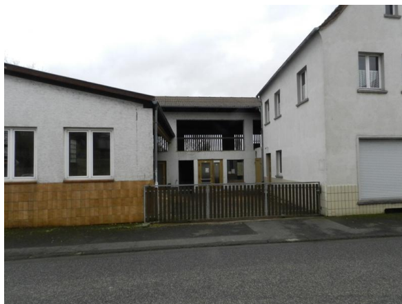
Foto 6: Fledermauskot im Dachstuhl Gebäude rechts
