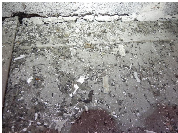
Foto 5: Fledermauskot auf einem Dachstuhlboden
