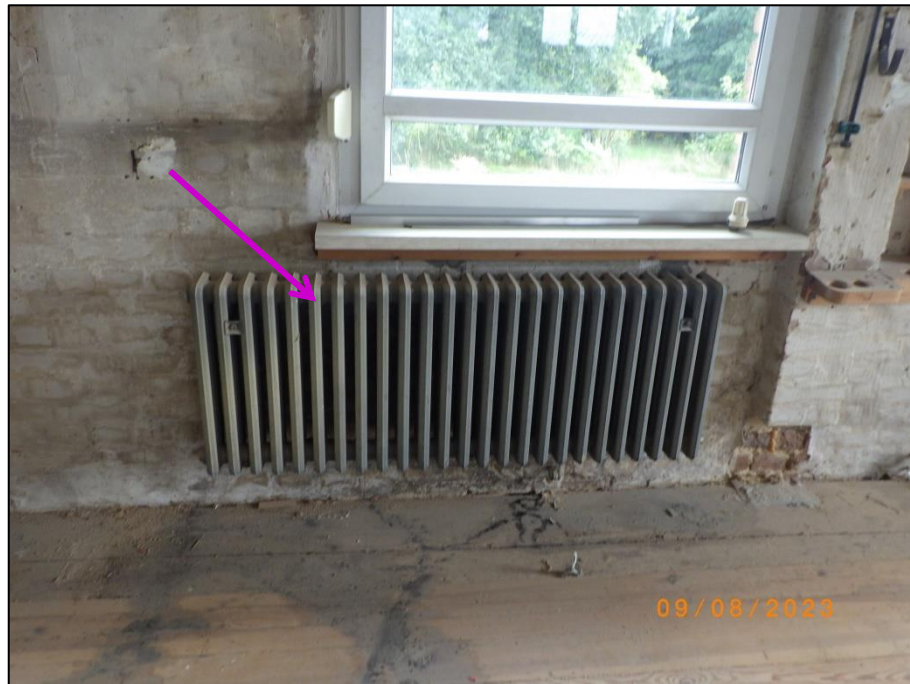
Foto 29 Werkstatt (37/10 + 11), EG: Hinweis auf asbesthaltige Flanschdichtungen in Rippenheizkörpern
