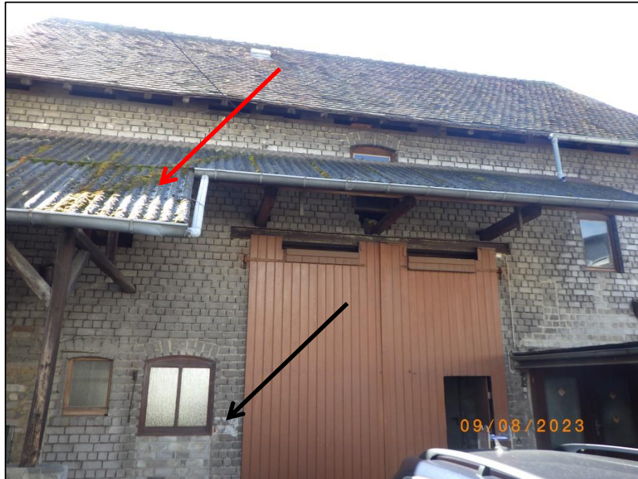
Foto 23 Scheune (37/4 + 5), Außenansicht: mit belastetem Mauerwerk (P 13) und Vordach mit AZ-Wellplattenabdeckung (P 15) , exemplarisch
