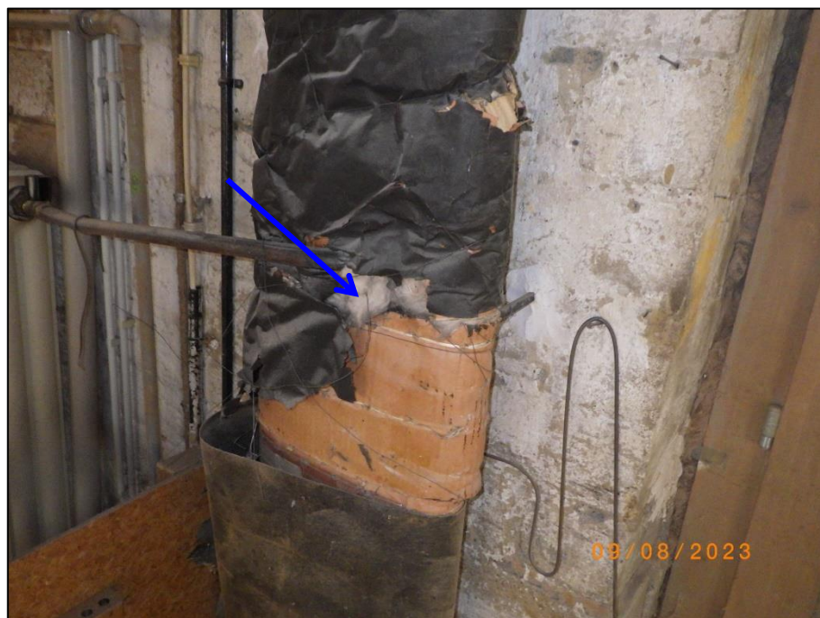
Foto 30 Werkstatt (37/11), EG: Heizleitung mit kaschierter KMF-Dämmung (P 18), exemplarisch
