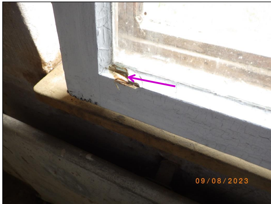
Foto 37 Werkstatt/Holzlager (37/15), EG: Fenster mit asbesthaltigem Kitt (P 21) , exemplarisch
