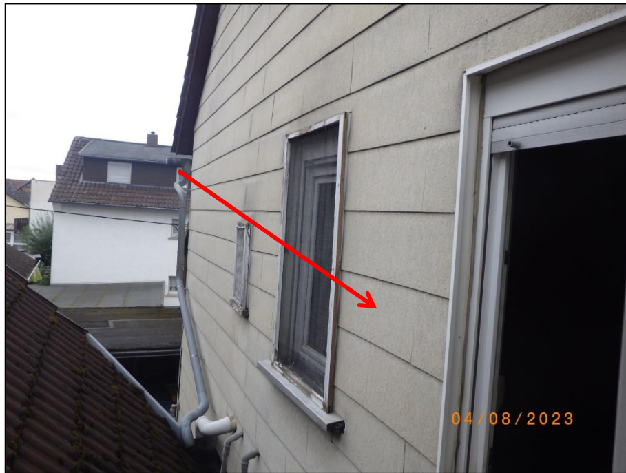
Foto 8 Wohngebäude (37/1), OG: Außenwandverblendung aus Asbestzement (P 4), exemplarisch
