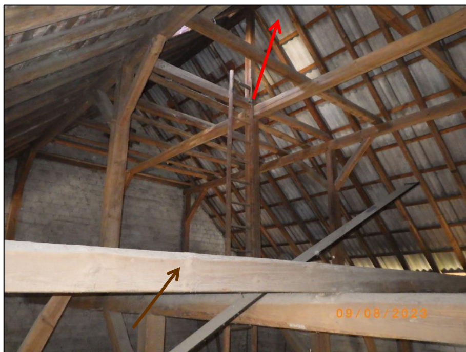
Foto 24 Scheune (37/4 + 5): mit A IV Holz Dachbalken (P 14) und AZ-Wellplattenabdeckung , exemplarisch
