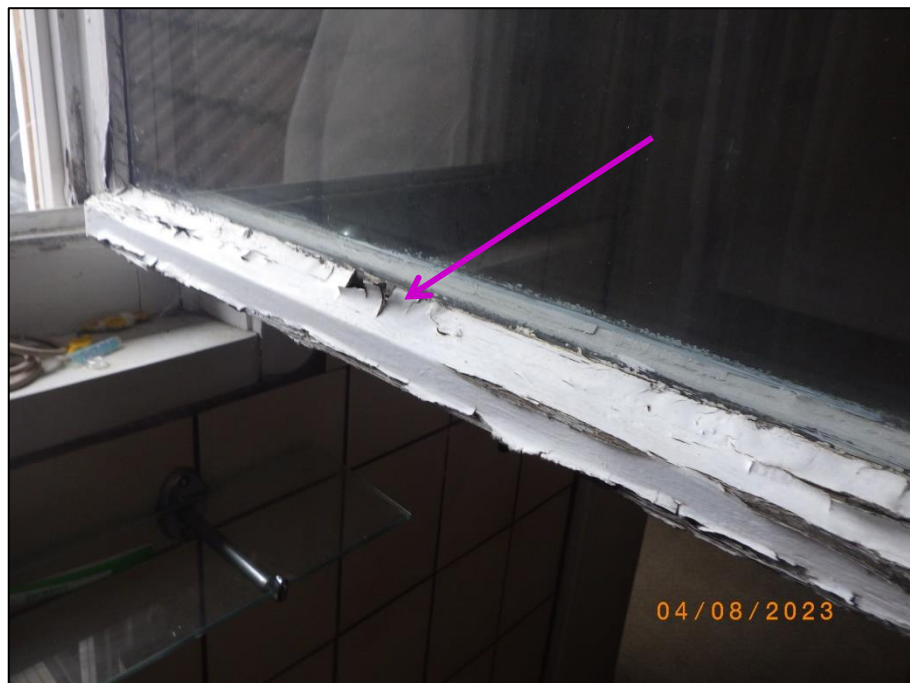
Foto 6 Wohngebäude (37/1),OG: Fenster mit asbesthaltigem Fensterkitt (P 5) , exemplarisch
