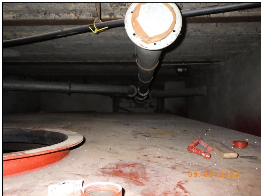
Foto 26 Werkstatt (37/11), KG: Heizöltank (ca. 9.900 Liter)
