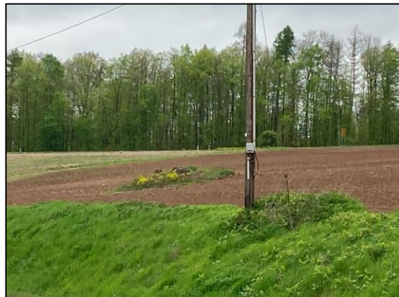
Abb. 7: 0,4 kV-Freileitung am Straßenrand
